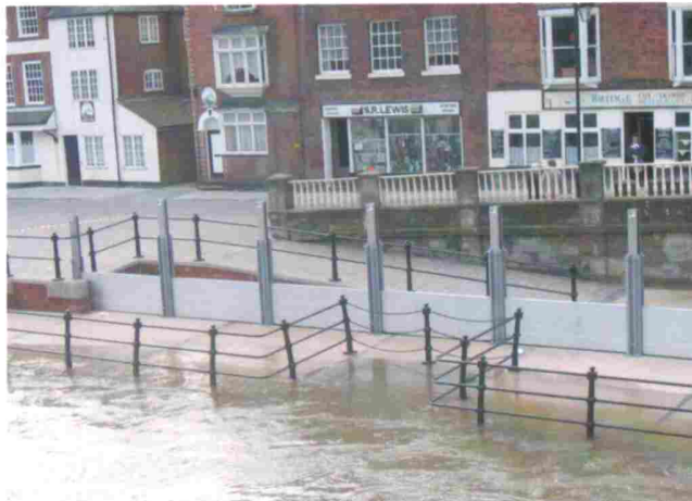
Po zamontowaniu dolnych belek zaporowych można stopniowo zwiększać wysokość ochrony przeciwpowodziowej
